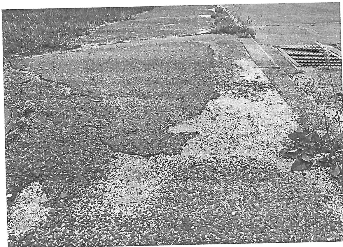
Zał. 4. Zdjęcie brakującej części chodnika
