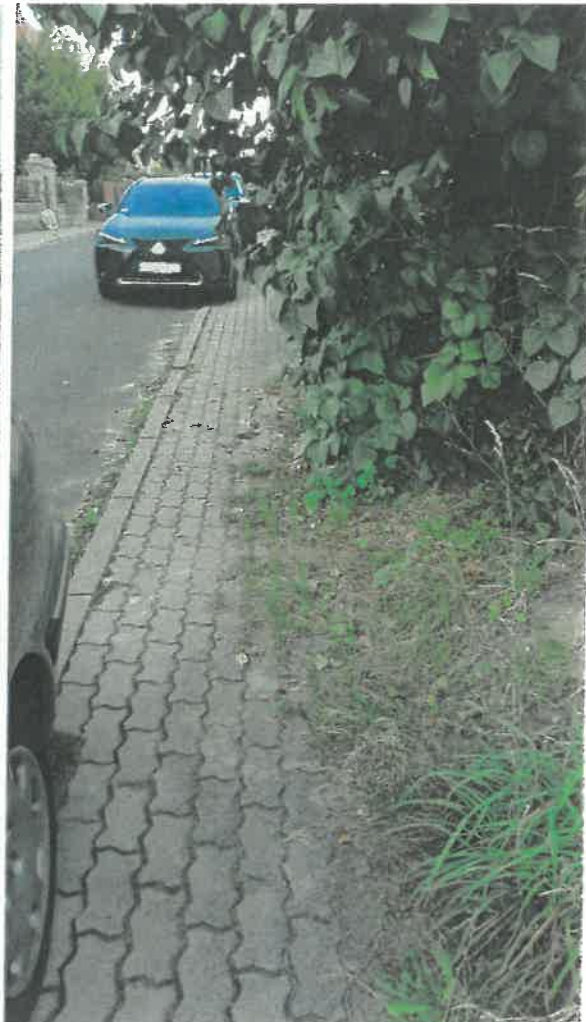
Ul. Marcinkowskiego – zawężenie chodnika.
