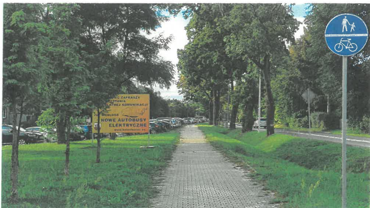
Ul. Kosiby – przerosty i darnie na chodniku i drodze rowerowej.
